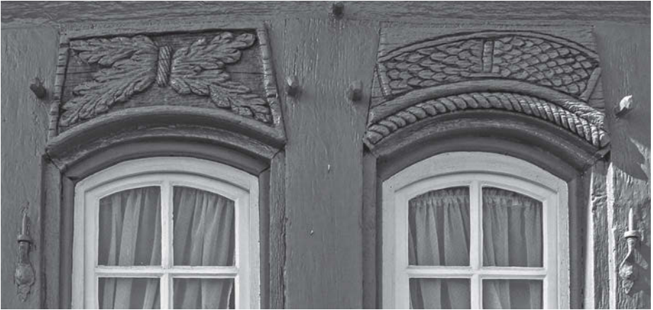
Abb. 13: Sturzriegel der beiden linken Fenster im ersten Dachgeschoss: Vier Akanthusblätter und ein Schuppenband.
